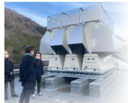
【ゆとりろ那須塩原】ヒートポンプ
